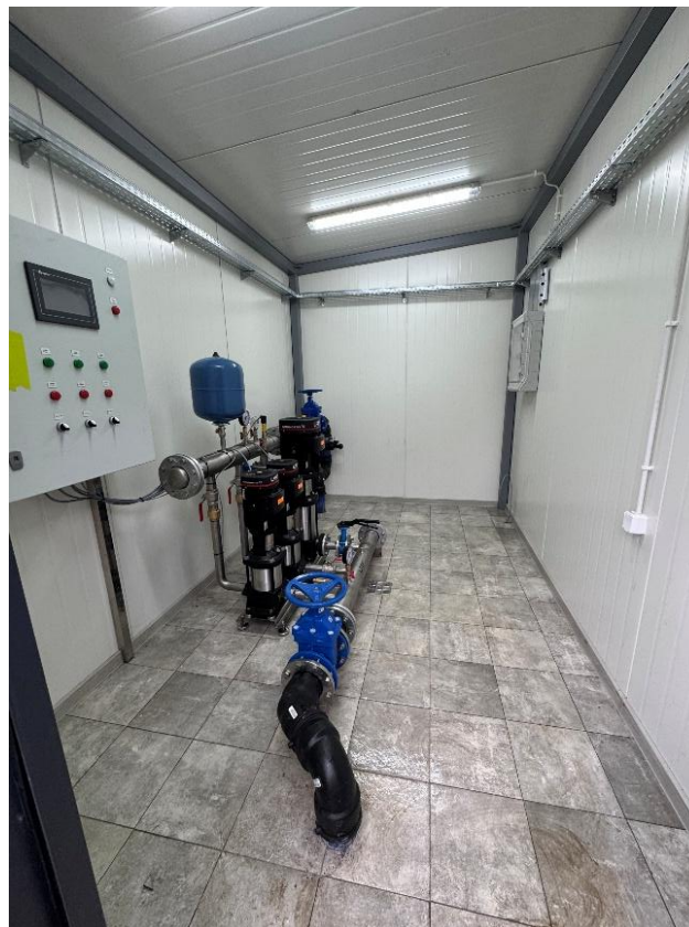
Pompownia wody w Niechobrze
