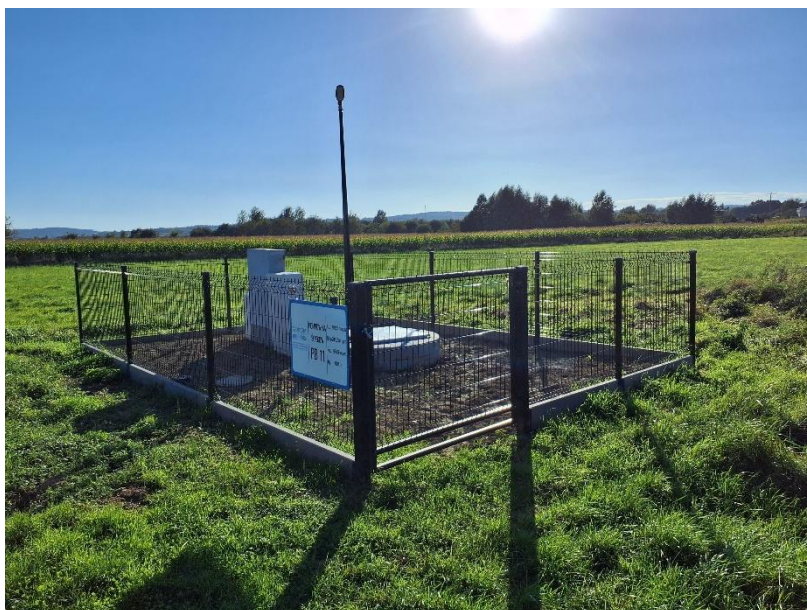
Pompownia ścieków PB 11
