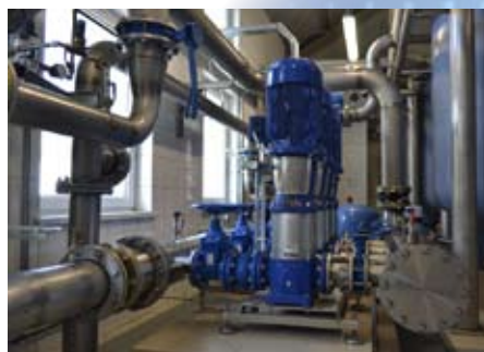
Stacja Uzdatniana Wody - Lutoryż
